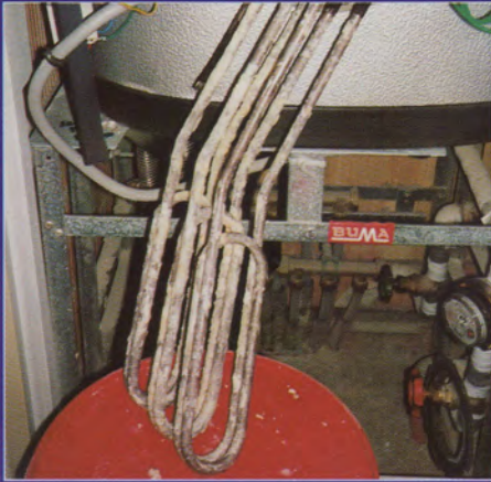
Heizstab nach 11 Monaten: Fast Kalkfrei
