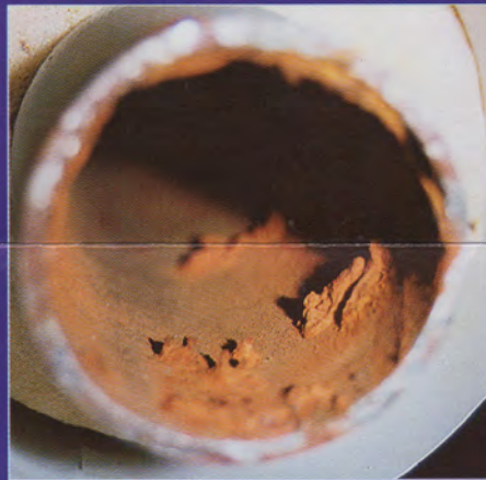
Rostbefall und Kalkstein erfolgreich saniert
