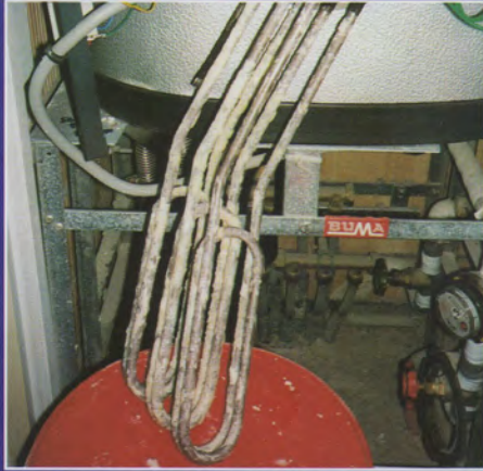
Heizstab nach 11 Monaten: Fast Kalkfrei
