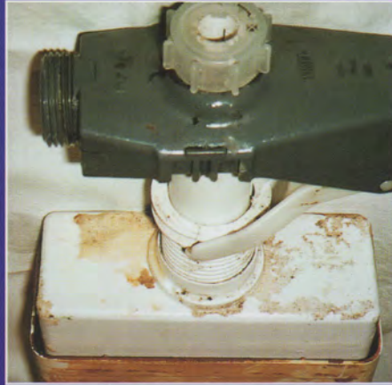
Schwimmer nach 9 Monaten: Ablagerungen saniert
