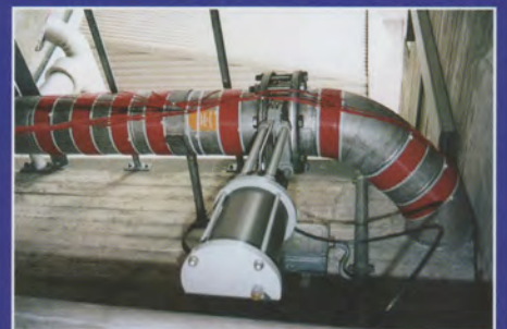
Rohr Klärwerk, Induktionsspulen
