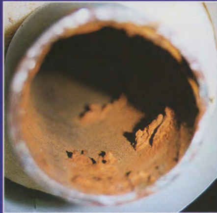
Rostbefall und Kalkstein erfolgreich saniert
